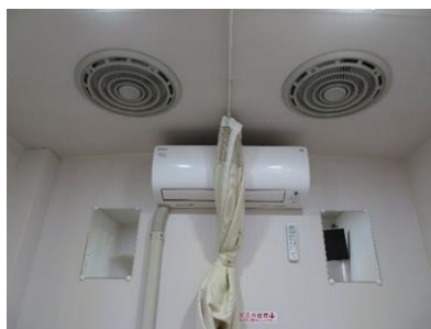
更衣室上部換気扇（個別）
